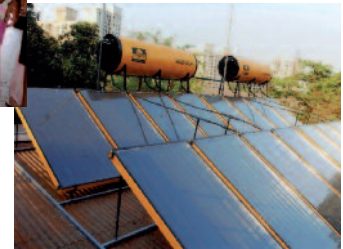
Die neue Solaranlage
